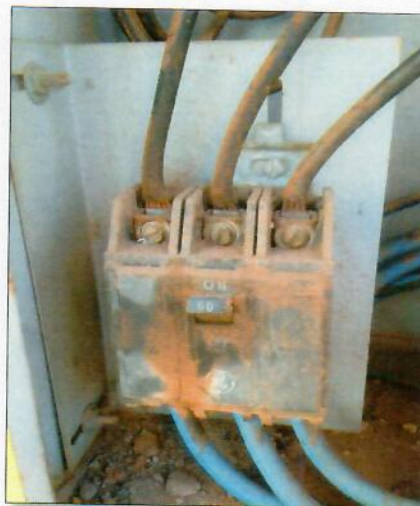
Figura 1: Disjuntor geral - Quadro de Medição
