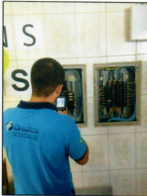
Figura 4: Inspeção Termográfica em Quadro de Distribuição
