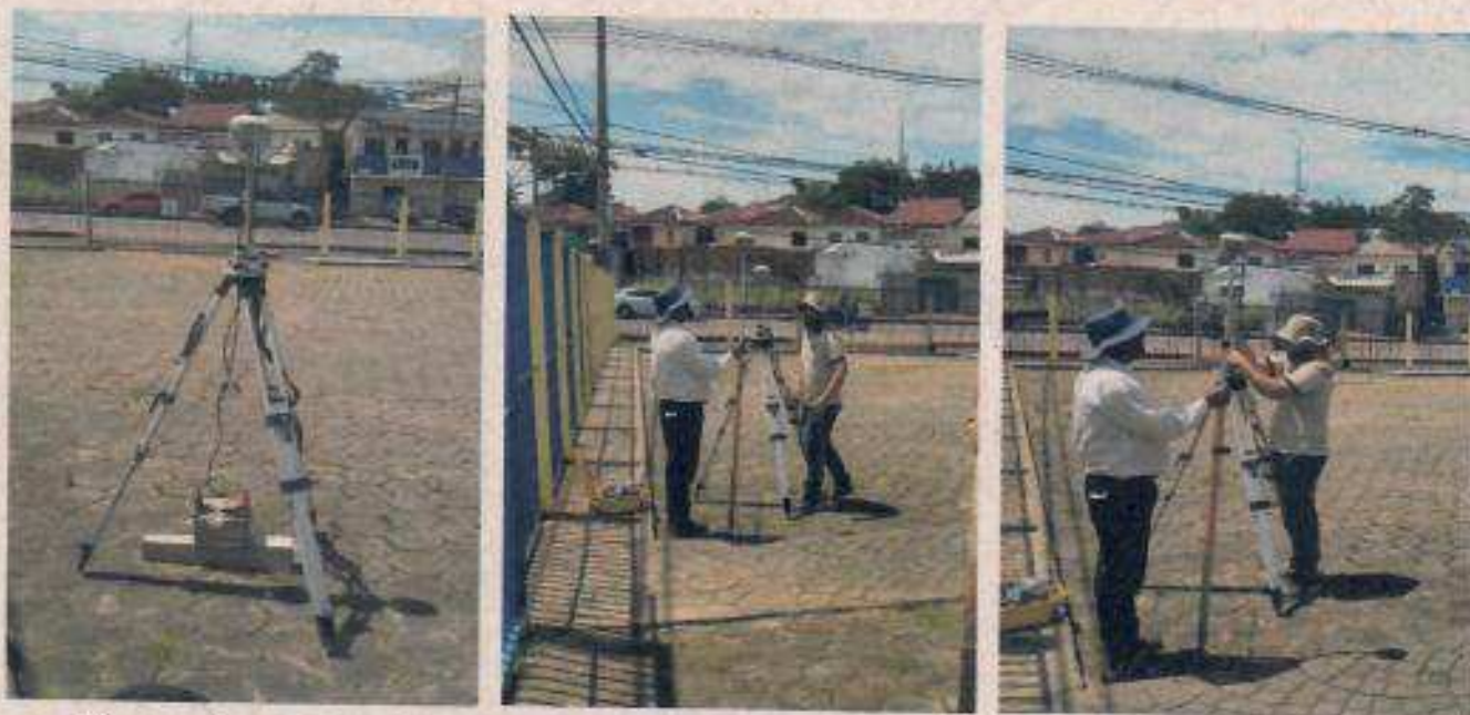
Figuras: Levantamento de cada vértice que compõe o perímetro do lote em questão mensurado.
